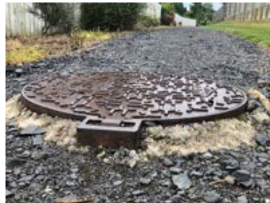
Figure 2-3: sharp edge hazard
